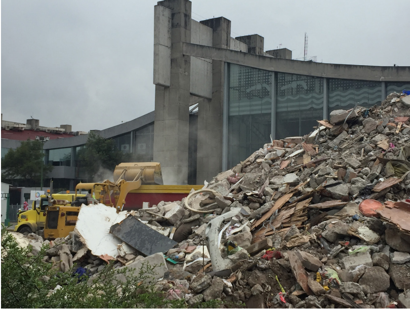
Escombros de edificios derrumbados, Alberca Olímpica. Colonia General Anaya, Delegación Coyoacán. Septiembre de 2017. Foto de Documenta desde Abajo
