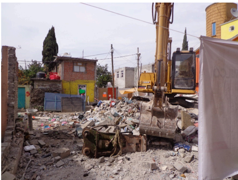
Etapa de limpieza de escombros y demolición. Pueblo de San Gregorio Atlapulco, Delegación Xochimilco. Diciembre de 2017. Foto de María Asunción Avendaño, coordinadora de brigada de Geografía-UNAM
