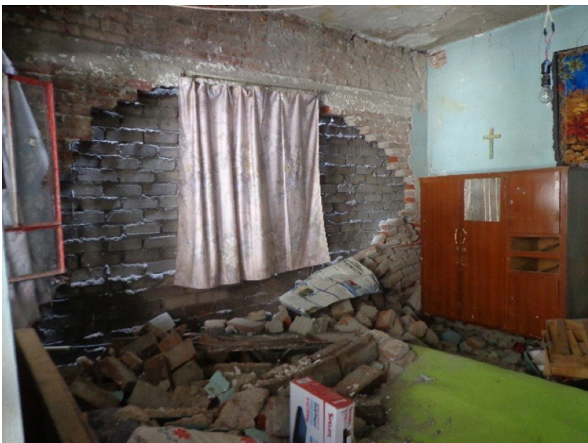
Interior de vivienda dañada por el sismo. Pueblo de San Gregorio Atlapulco, Delegación Xochimilco. Octubre de 2017. Foto de María Asunción Avendaño, coordinadora de brigada de Geografía-UNAM
