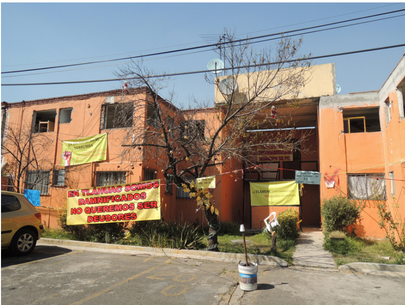
Departamentos con daños estructurales graves en la Unidad Habitacional Villa Centroamericana. Colonia Villa Centroamericana, Delegación Tláhuac. Noviembre de 2017. Foto de Ámbar Paz, brigadista de CIESAS
