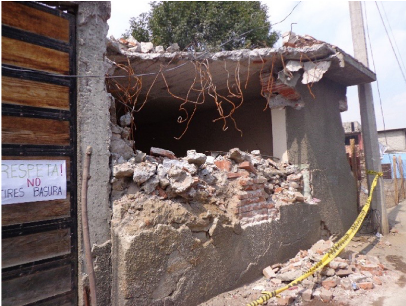
Vivienda dañada por el sismo. Pueblo de San Gregorio Atlapulco, Delegación Xochimilco. Octubre de 2017. Foto de María Asunción Avendaño, coordinadora de brigada de Geografía-UNAM
