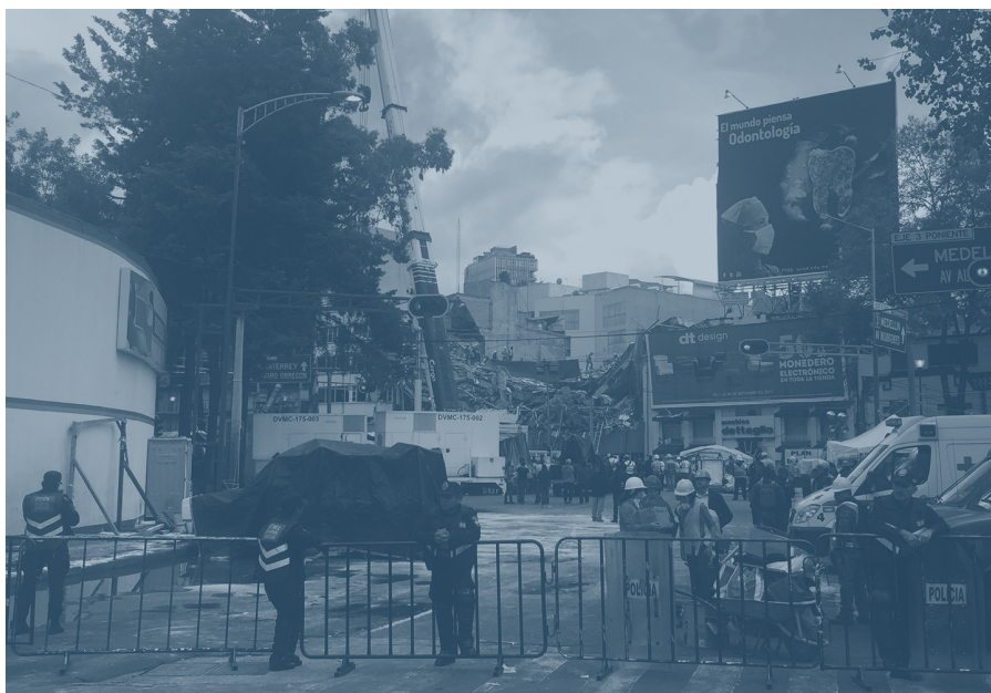
Obras de rescate, edificio Álvaro Obregón 286. Colonia Roma, Delegación Cuauhtémoc. Octubre de 2017. Foto de Documenta desde Abajo
