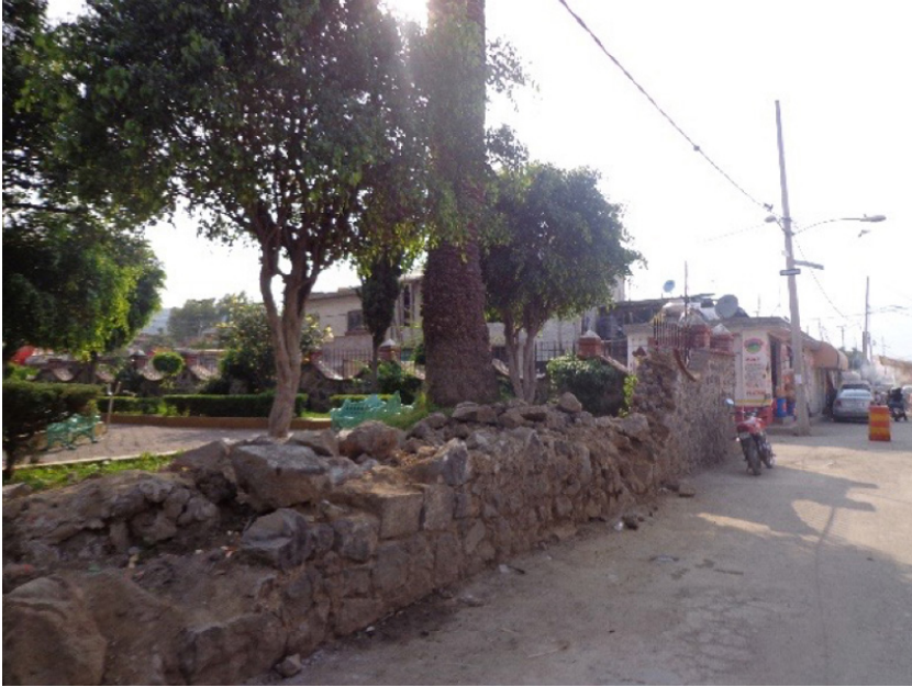
Barda de la iglesia dañada por el sismo. Pueblo de San Gregorio Atlapulco, Delegación Xochimilco. Octubre de 2017. Foto de María Asunción Avendaño, coordinadora de brigada de Geografía-UNAM
