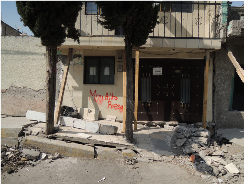
Daños en calle y banqueta. Colonia del Mar, Delegación Tláhuac. Octubre de 2017. Foto de Ámbar Paz, brigadista de CIESAS
