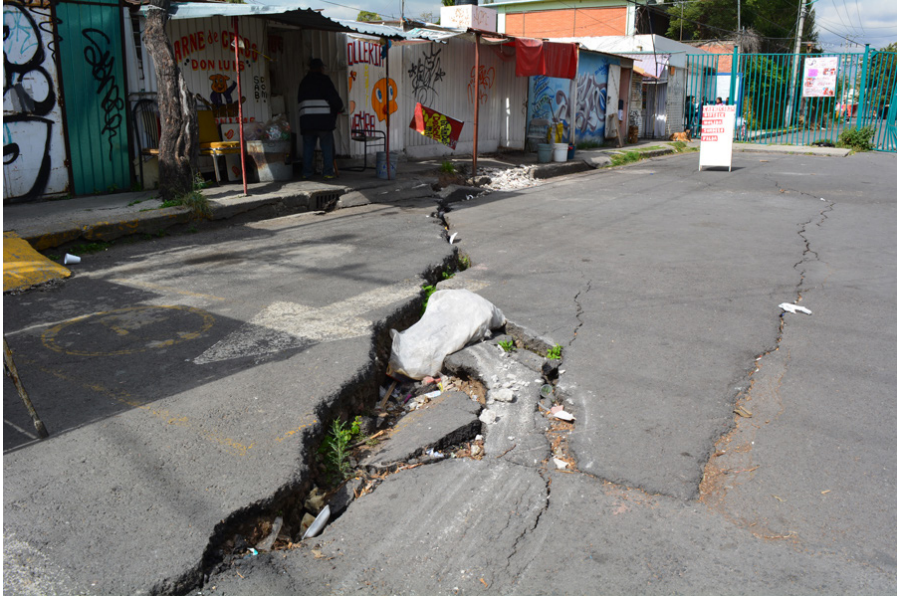
Grieta en la calle. Colonia Villa Centroamericana, Delegación Tláhuac. Octubre de 2017. Foto de Eva Bidegain, brigadista de CIESAS
