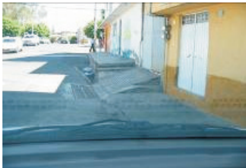
Figura 6. Combinación de rampas vehiculares y de escalones que obstruyen la banqueta.
